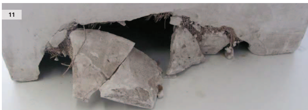
Obr. 11: Mechanické poškození soklu.
