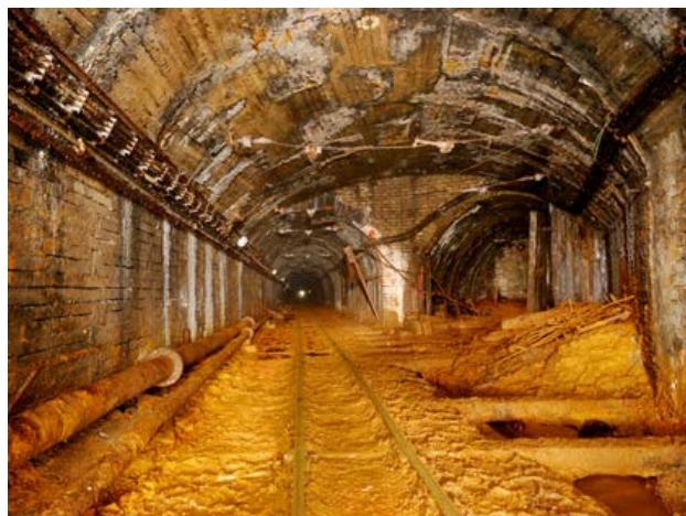
Obr. 58 Vrstva železitého okru na počvě dopravního překopu v úrovni 16. patra dolu Skalka. Archivní foto, M. Korba.
